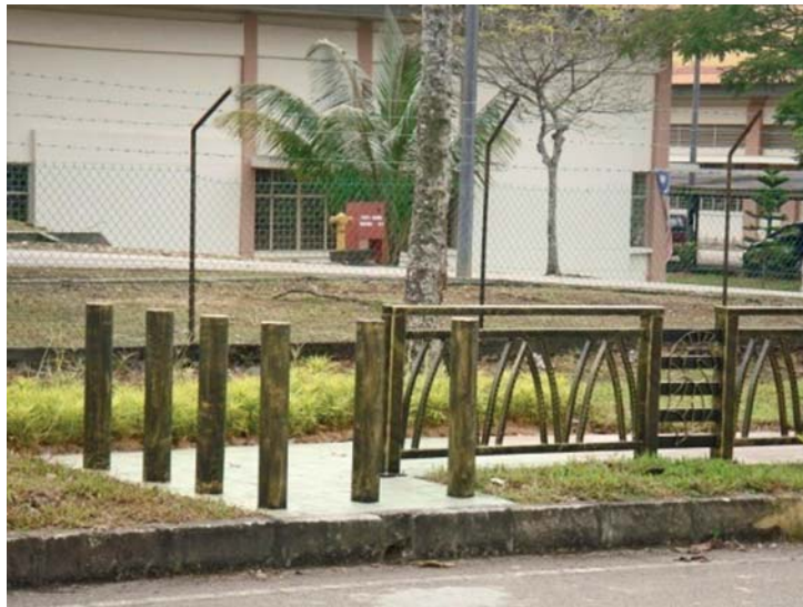
Pemasangan tonggak jalan dan rel penghadang yang digabungkan di laluan pejalan kaki
