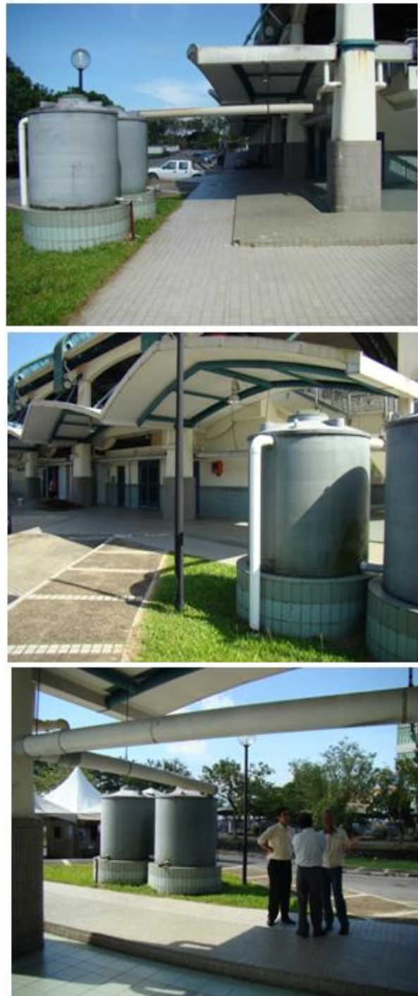
Foto 30 : Contoh Tangki Air Hujan Di Bangunan Awam (DBKU)
