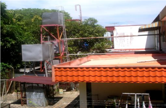
Foto 36 : Plumbing Tidak Teratur Memburukkan Pemandangan Kawasan Perumahan
