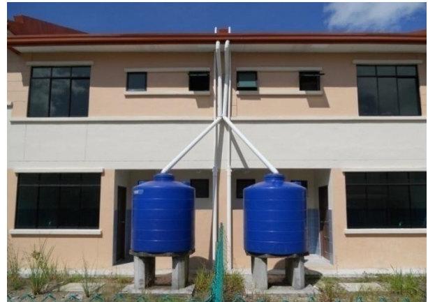
Foto 12 : Air Hujan dari Bumbung Rumah disalurkan melalui Gutter dan disimpan dalam Tangki Air
