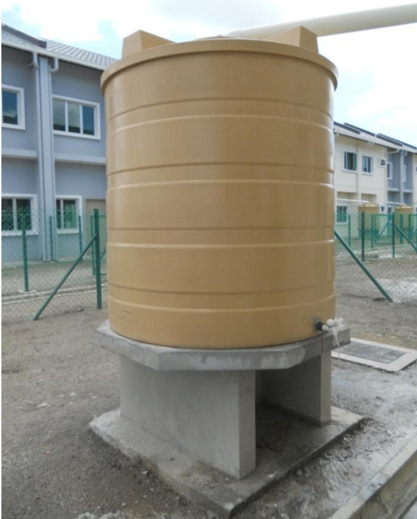
Foto 18 : Tangki Air Di Atas Tanah
