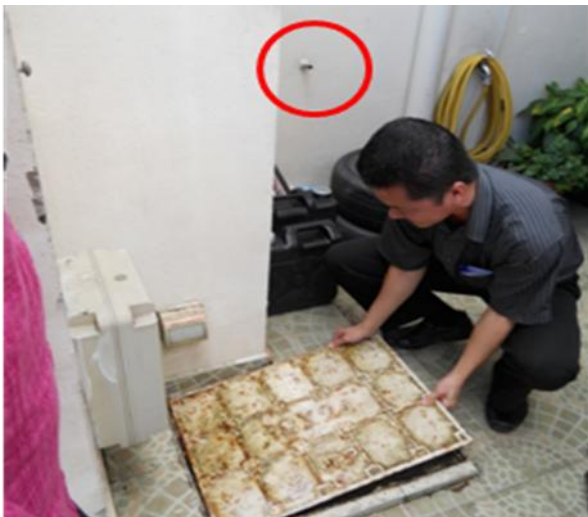
Foto 27 : Kedudukan Paip Air Hujan Dipam Keluar Dari Tangki Air Bawah Tanah
