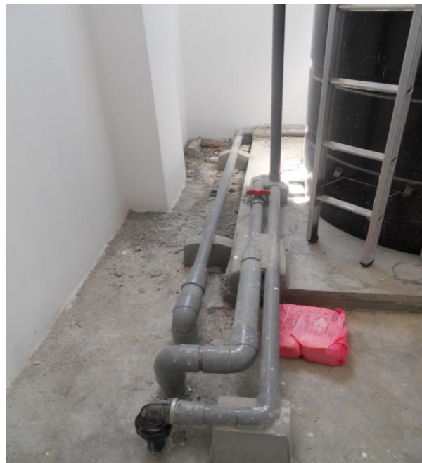
Foto 32 : Sistem Plumbing Yang Menyalurkan Air Dari Bawah Tanah Ke Tangki Air
